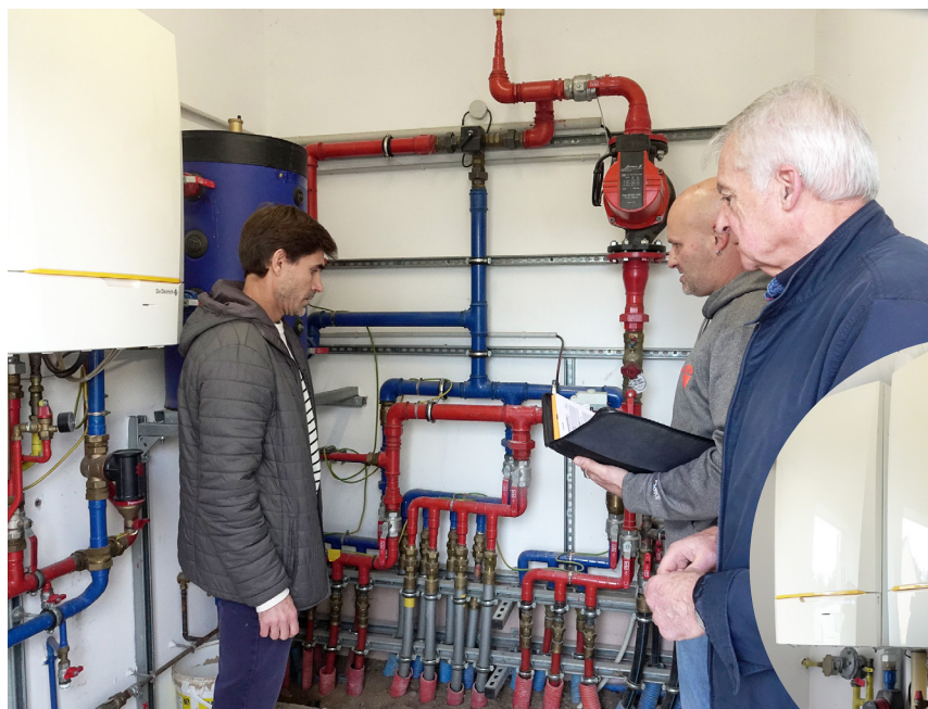
Thomas Bédot, conseiller du service d'accompagnement à la maîtrise de l'énergie des collectivités du Parc naturel régional du Gâtinais français, accompagne une commune pour un fonctionnement optimal de sa chaudière.
