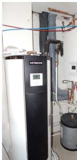
Ancienne chaudière fioul et nouvelle pompe à chaleur
