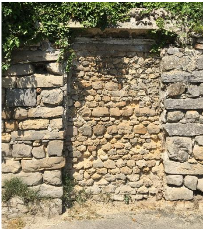
Porte piétonne condamnée, PNR du Gâtinais français
