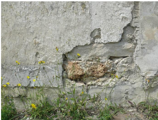
Enduit couvrant usé avec pierre en dessous
