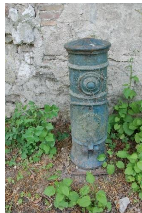
Bouche d'incendie, rue Charles de Gaulle - Marlanval
